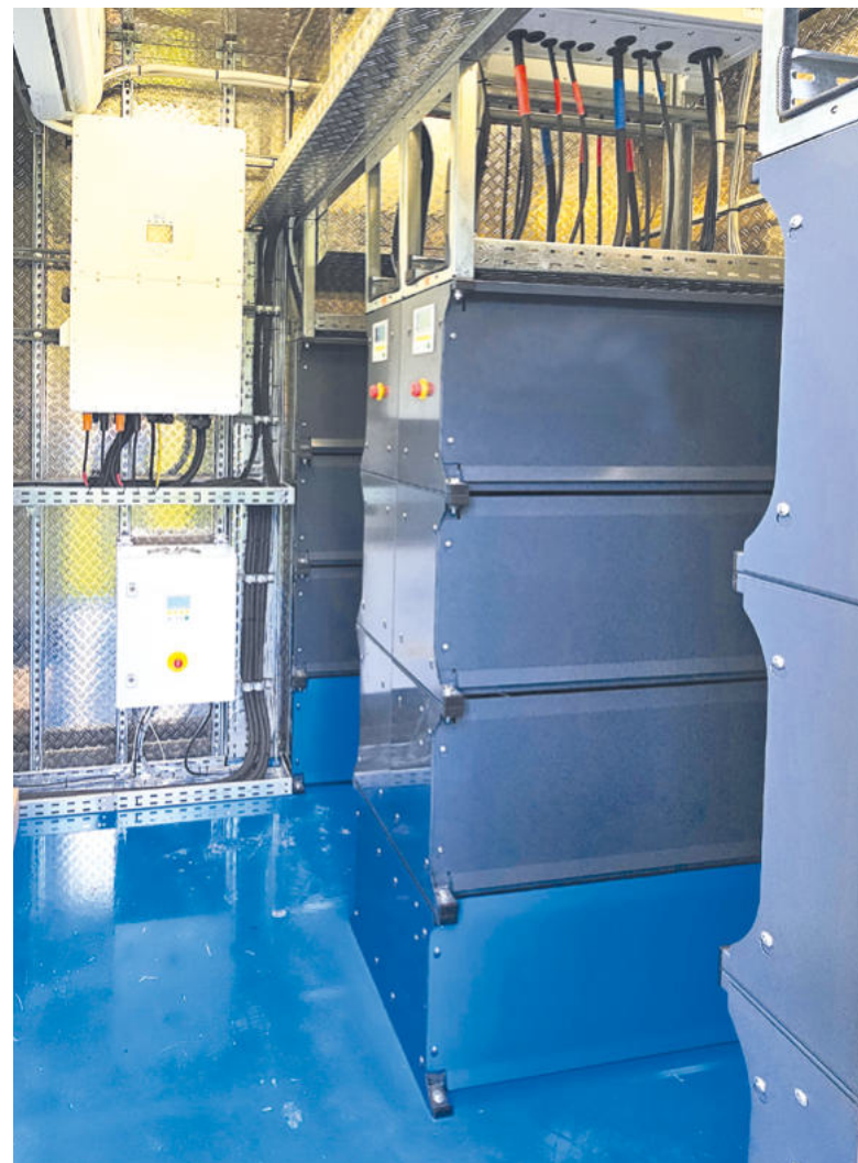
Innenansicht des Stromspeichers am Eichhof.
